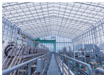
多核種除去設備 (ALPS)
